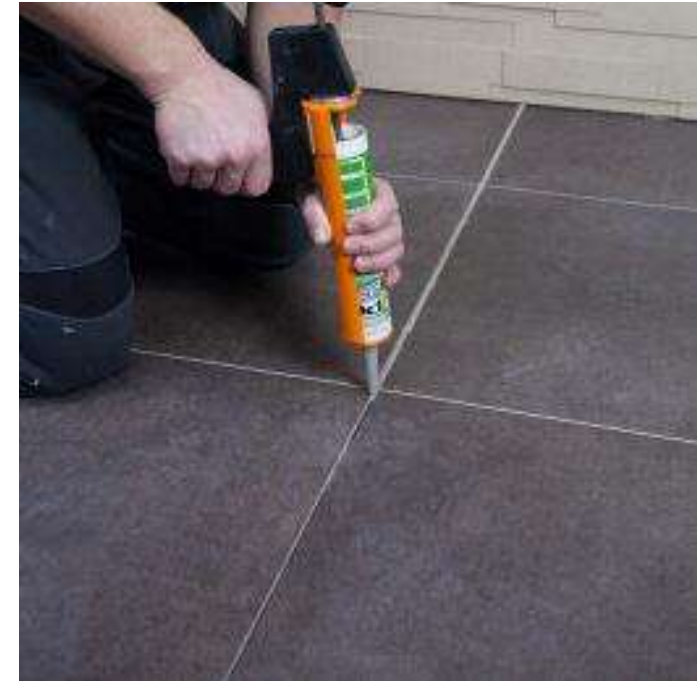
15. Nach dem Verfugen der Bodenfläche mit PCI Nanofug ® Premium erfolgt die Versiegelung der an die Trennfuge angrenzenden Belagsfuge mit PCI Silcofug ® E. Diese muss nicht breiter als die übrigen Belagsfugen ausgeführt werden. Und fügt sich so harmonisch in das Fugenbild ein.
