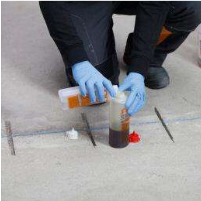
7. Sind die Nuten so weit vorbereitet, werden die beiden Komponenten von PCI Apogel® SH zusammengeschüttet ...
